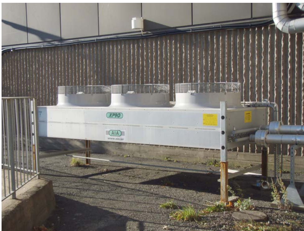
Figur 6.3 Frikylaren i pilotanläggningen. En traditionell kylmedelskylare med dysanordning för spray-vätning av värmeväxlarpaketet
